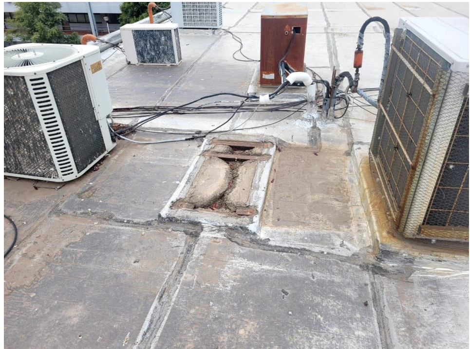
EDIFICIO CAMPUS – CS. HUMANAS – SECTOR DE EQUIPOS
