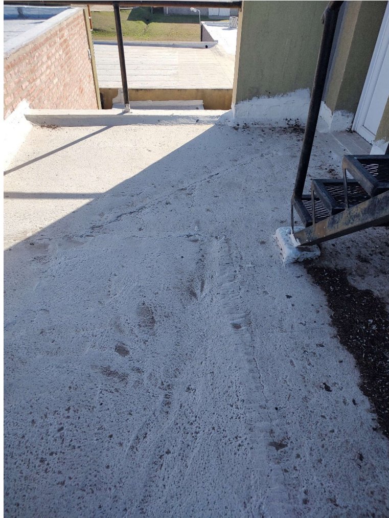
PLANTA PILOTO – ACCESO A TANQUES
