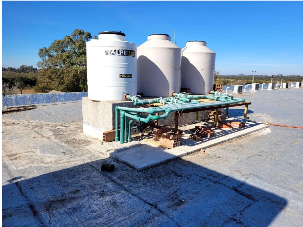
EDIFICIO MICROBIOLOGIA – SECTOR TANQUES
