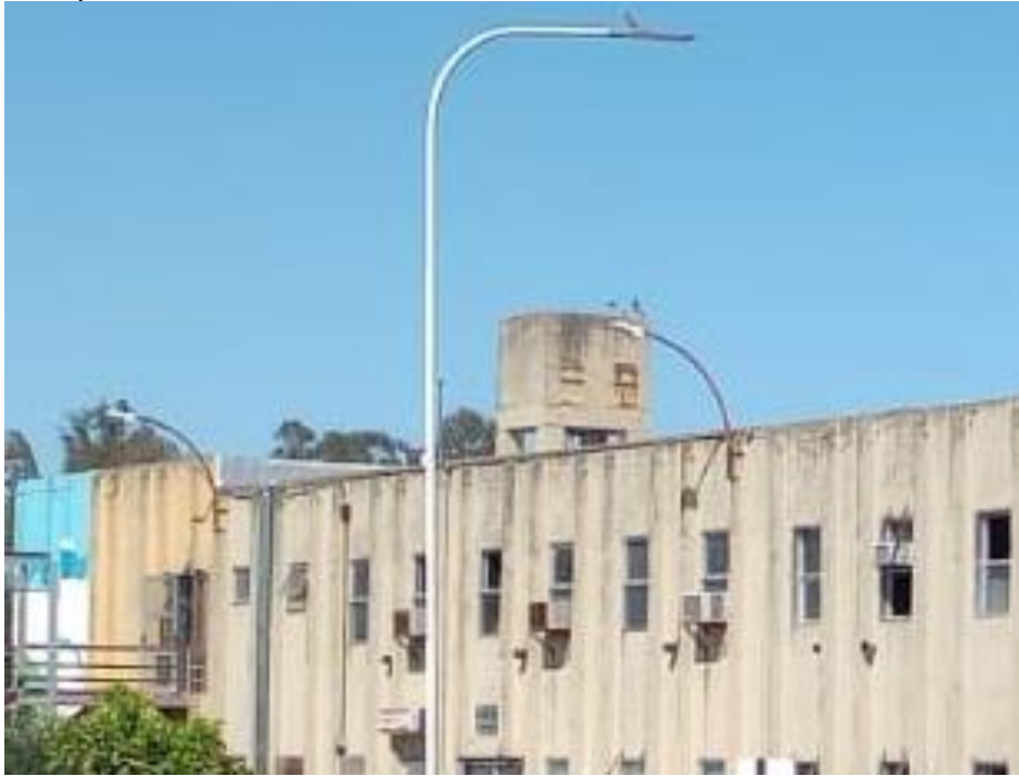
Tanque de reserva sobre cubierta
